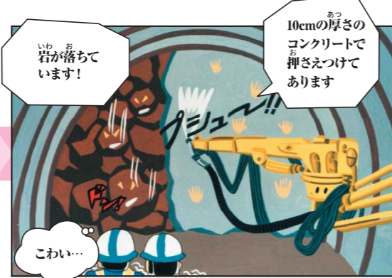
5 一次コンクリート吹付 崩れないようにコンクリートを吹き付けて掘った部分を固めます。
